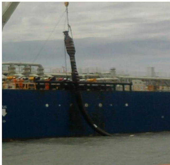
Ilustración 14. Lancha de apoyo toma la punta de la grúa, toma la manguera y la levanta sobre la cubierta para que los sup de carga hagan firme la cadena a la cubierta.
